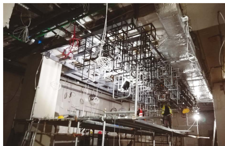
Δοκιμαστικές εργασίες εφαρμογής της μεταλλικής κατασκευής οροφής του bar πριν από το τελικό στάδιο.
